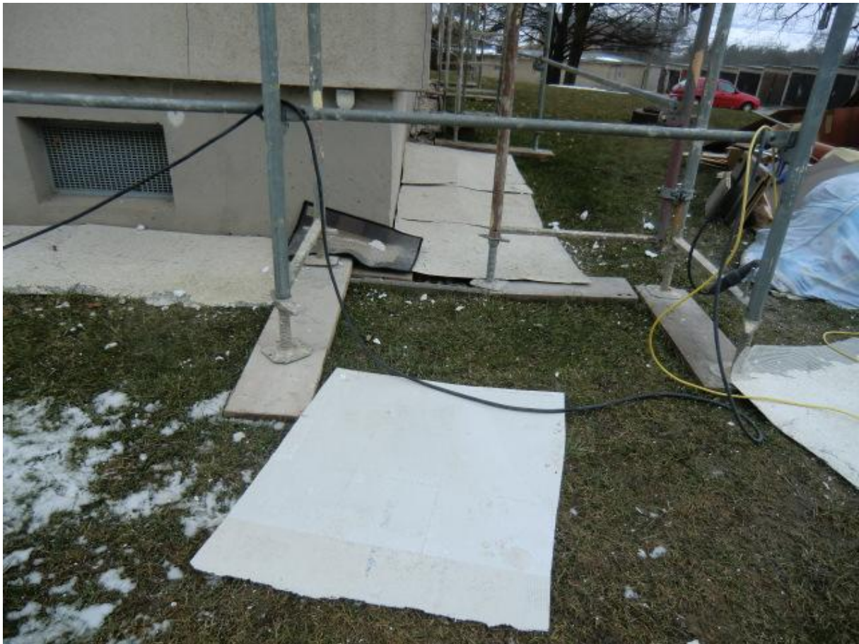
Foto 4 – Ansicht der Rückseite des Deckputzes, einschließlich Gewebe und Spachtelung; nur wenig Bestandteile des Polystyrols hafteten daran
