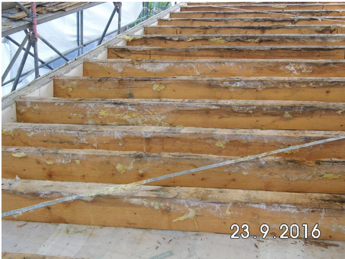
Freigelegte Holzbalken mit starken Schäden
