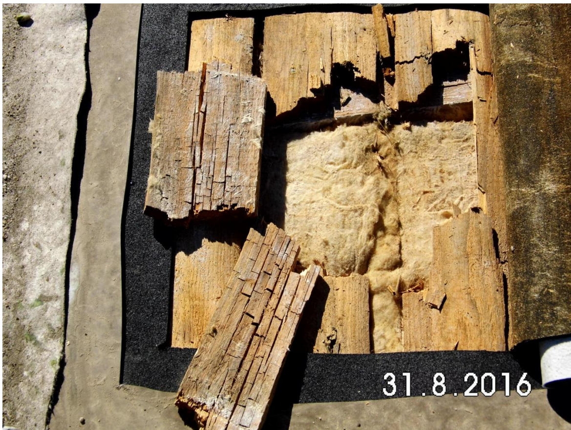
Bretter unter der Dachabdichtung völlig zerstört
