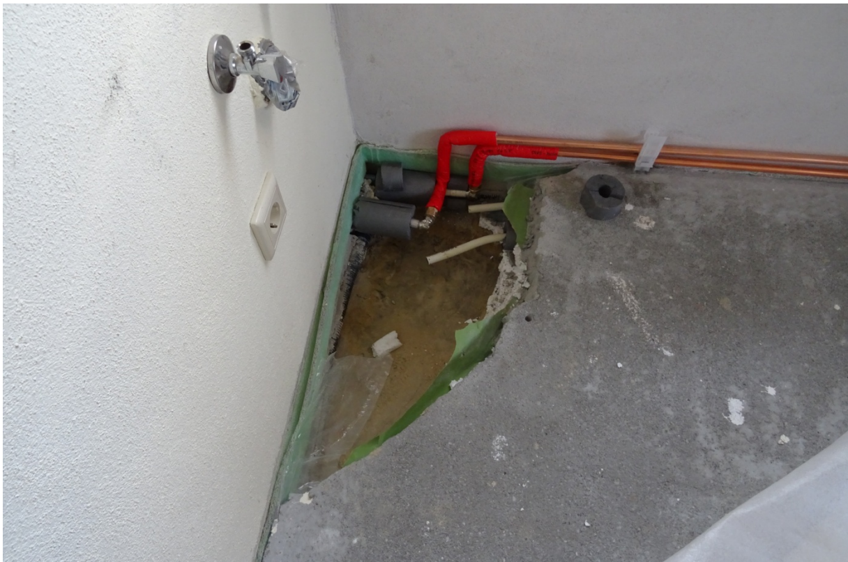
Foto 1 – Bereich, wo sonst Küchenmöbel stehen; an der Außenwand verlegte Heizleitung, ( nach dem Entfernen des Schimmels an der Außenwand )
