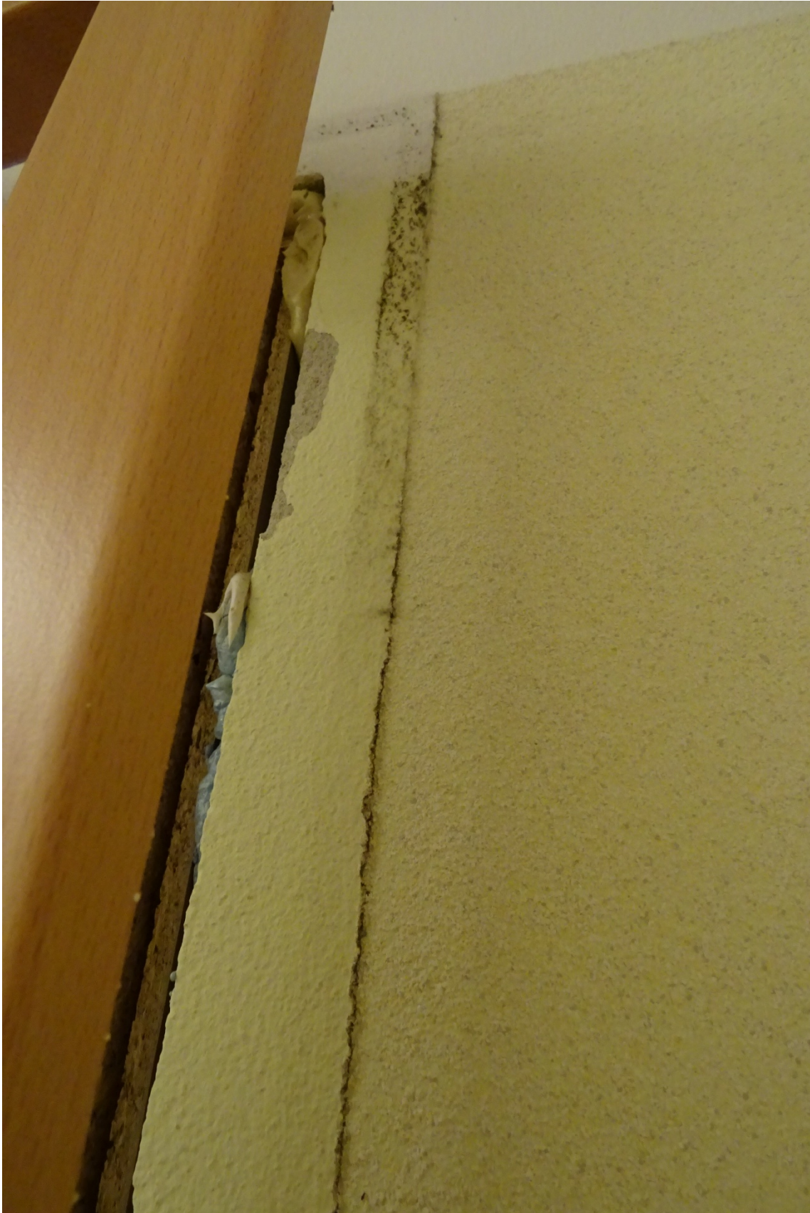
Foto 5 - Schimmelpilzbildung hinter einer Innentürzarge
