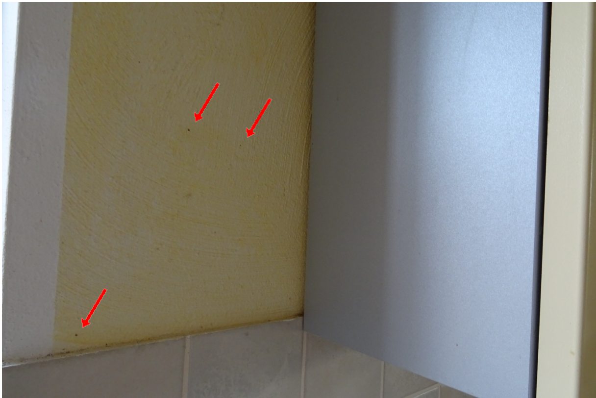
Foto 2 – Kleine Flecken ( rote Pfeile ), die nicht abwischbar waren, sind keine Schimmelpilze
