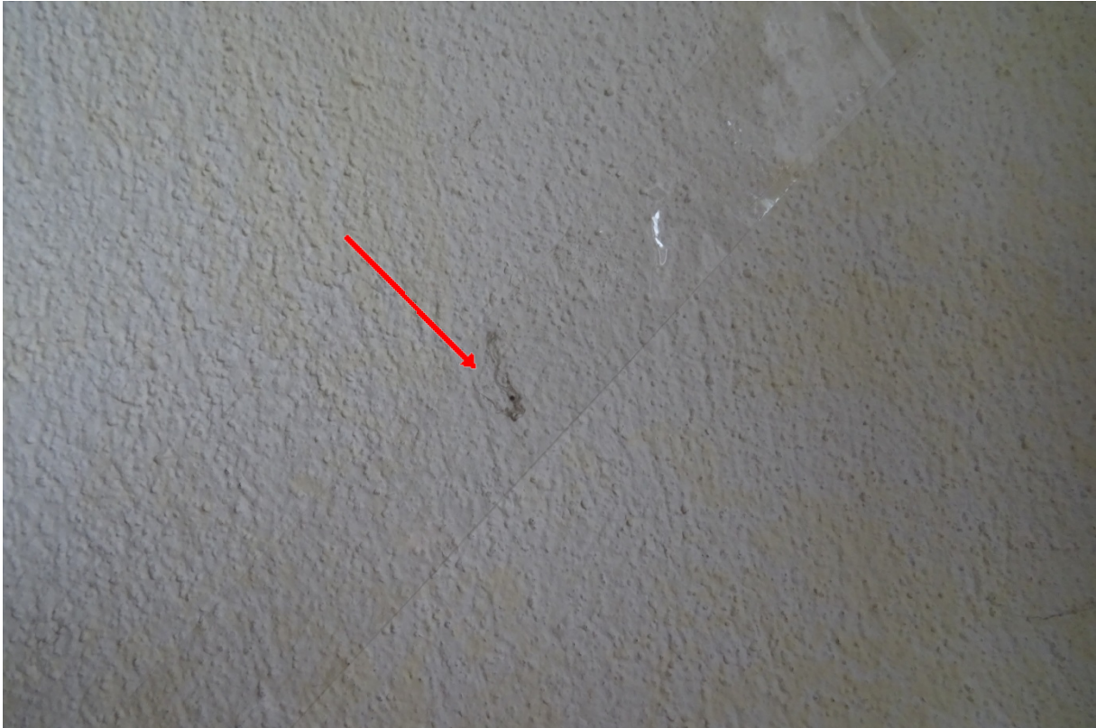
Foto 3 – Fussel an der Wand ( roter Pfeil ), die vom Labor als Spinnweben bewertet wurden
